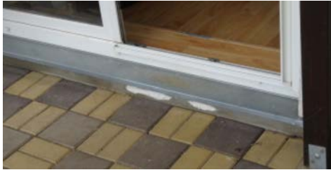
tzv. měkký práh u francouzského okna, poškozený povrch soklu
