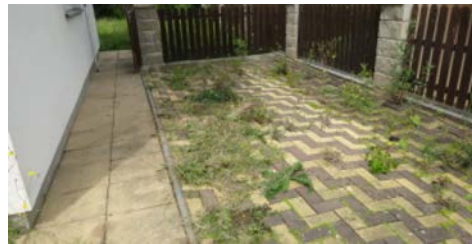
degradovaná plocha parkovacího místa
