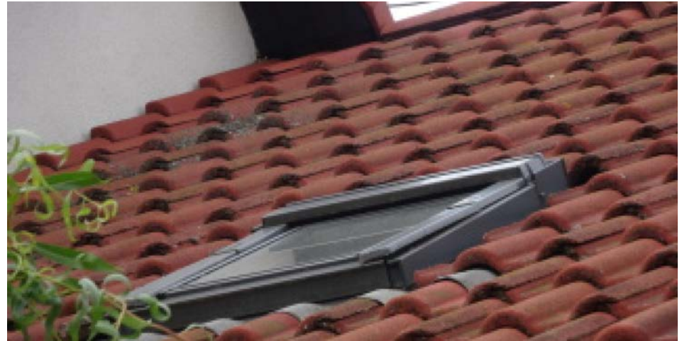
biotické znečištění střechy
