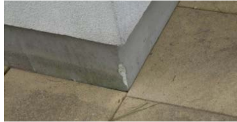
poškozený povrch soklu, sokl bez finální povrchové úpravy
