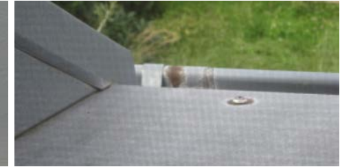
Koroze na parapetu a okapu
