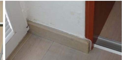
opravovaná omítka u dveří na balkon
