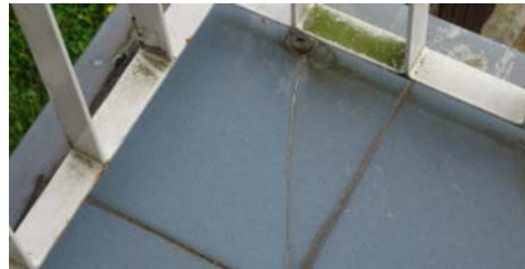
Prasklá dlaždice na balkonu
