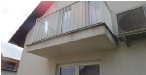
známky po zatékání pod oplechován balkonu
