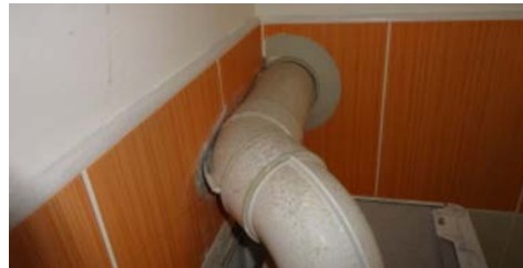
kouřovod bez revizního vstupu
